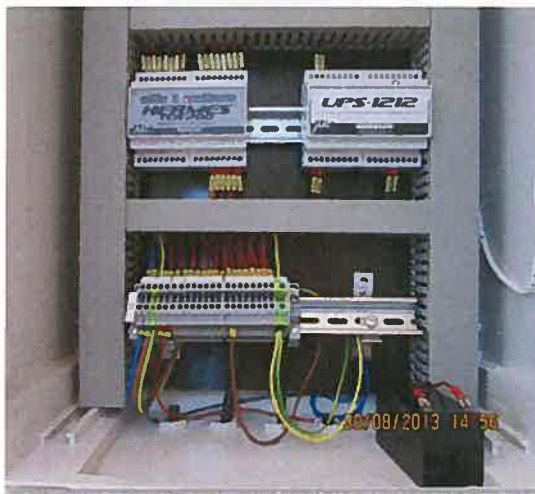
Ejemplo Fotografía interior cuadro con TCR200
